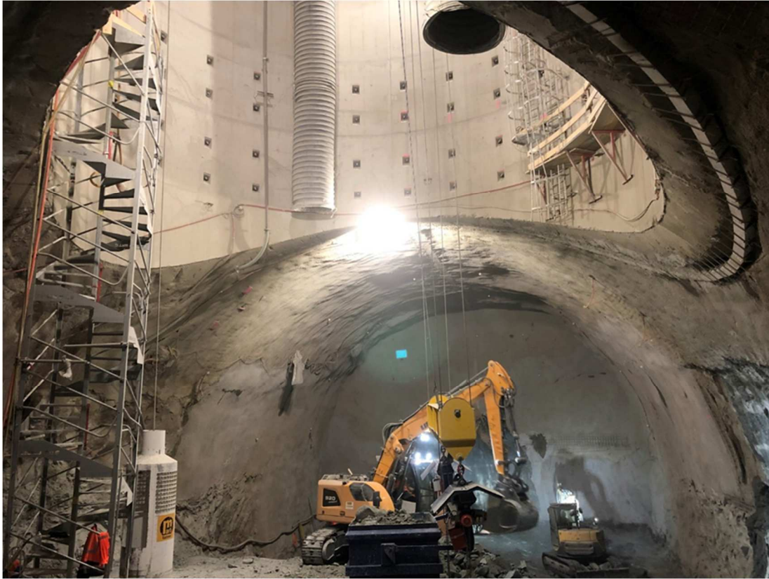
Figure 10. Installation des éléments compressibles entre le puits renforcé PM17 et la caverne US/UW17
